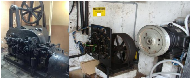
Ilustración 6. Imágenes de instalaciones obsoletas.
